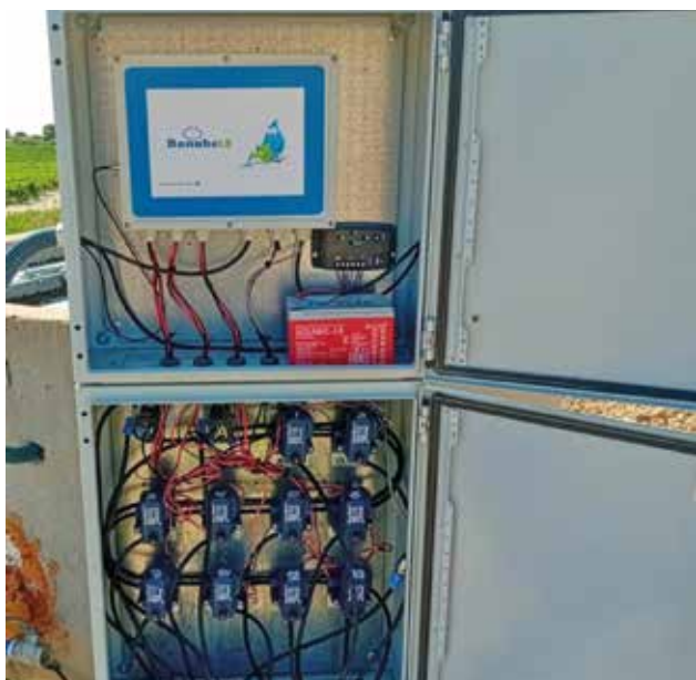
Danube telecontrol: programador Danube para el telecontrol del riego.
