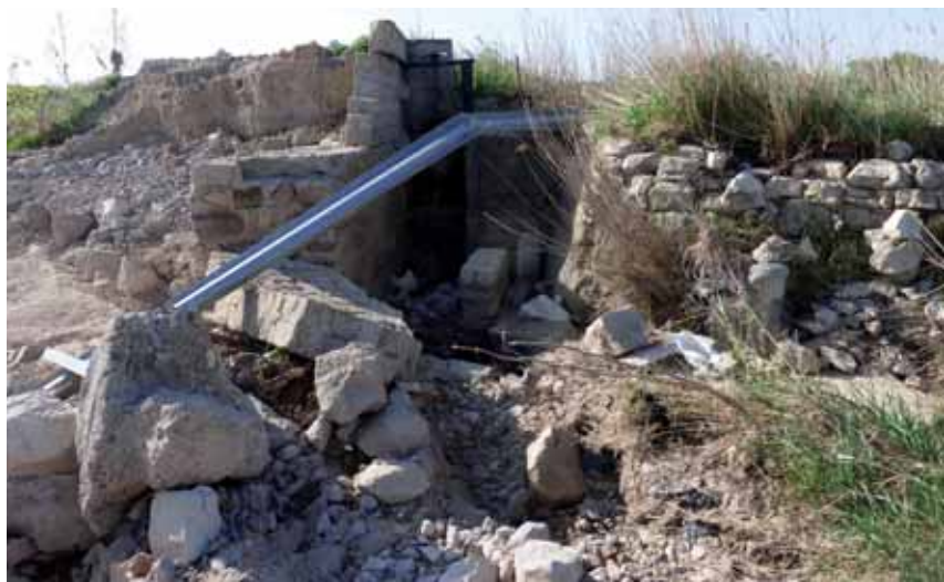
43 municipios solicitaron ayuda por los daños en las infraestructuras municipales
